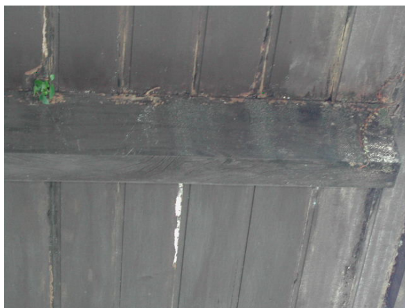
Fotografia 4 - Forro e Caibro deteriorado
