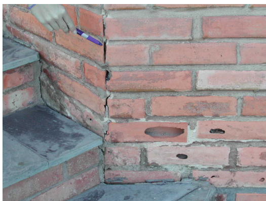
Fotografia 2 - Rachadura entre paredes e tijolo quebrado
