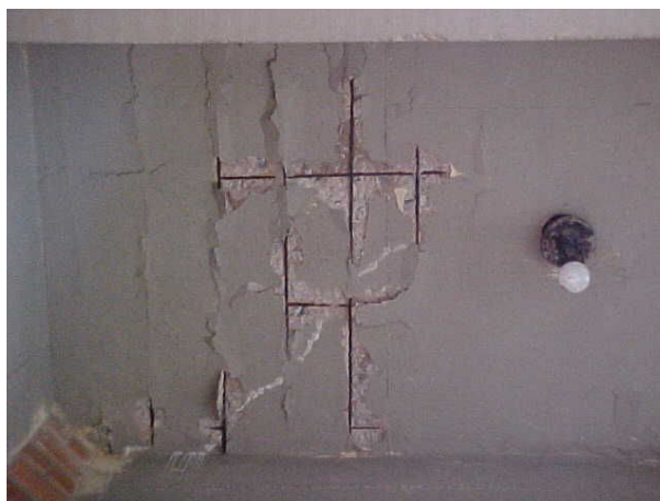
Fotografia 1 - Armadura exposta e descolamento do concreto
