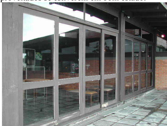
Fotografia 5 - Aberturas, Janelas Fixas e bandeiras deterioradas.
