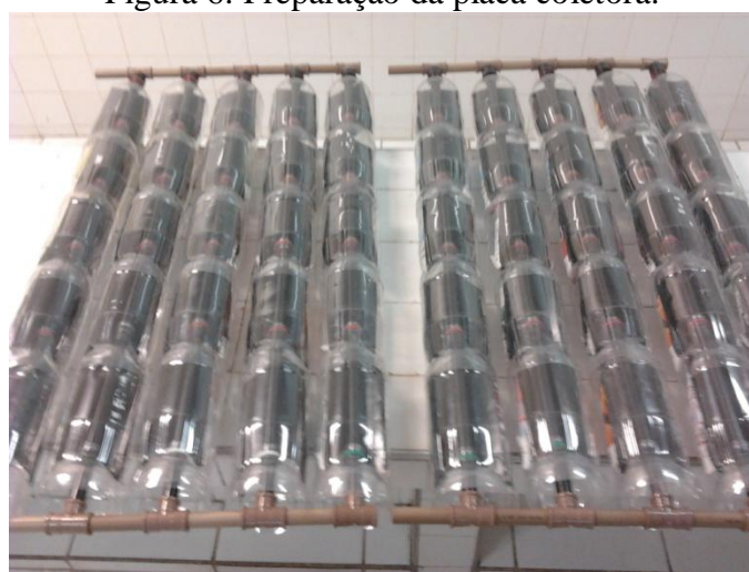
Figura 7: Placa coletora com capacidade para aquecer 50 litros.
