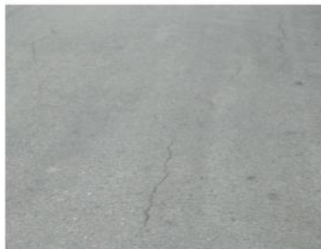
Figura 10 - Trincas longitudinais encontradas na estação 03.
