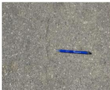
Figura 9 - Trinca. Fissura encontrada na estação 29
