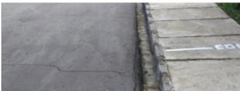
Figura 11 - Trincas transversais encontradas na estação 01.
