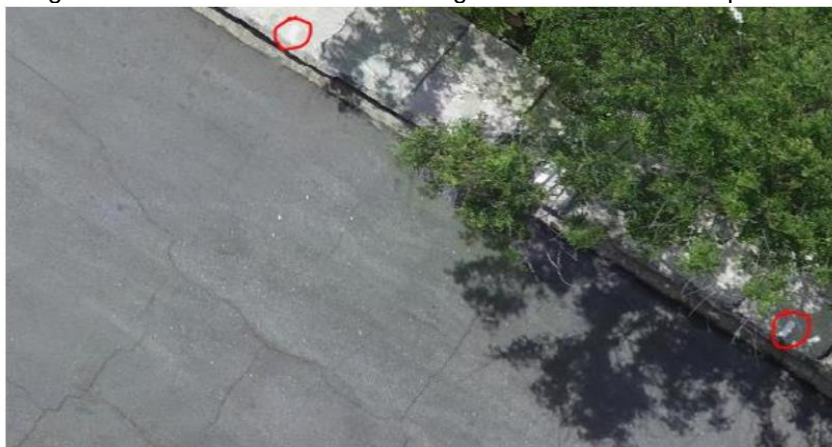
Figura 13 - Trincas transversal e longitudinal observadas a partir do drone.
