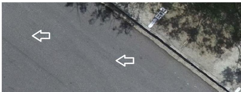
Figura 12 - Trincas longitudinal observada a partir do drone.
