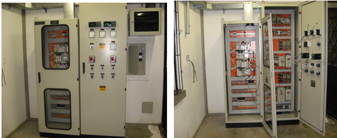
Figura 1. Foto dos painéis do CCM e CLP.
