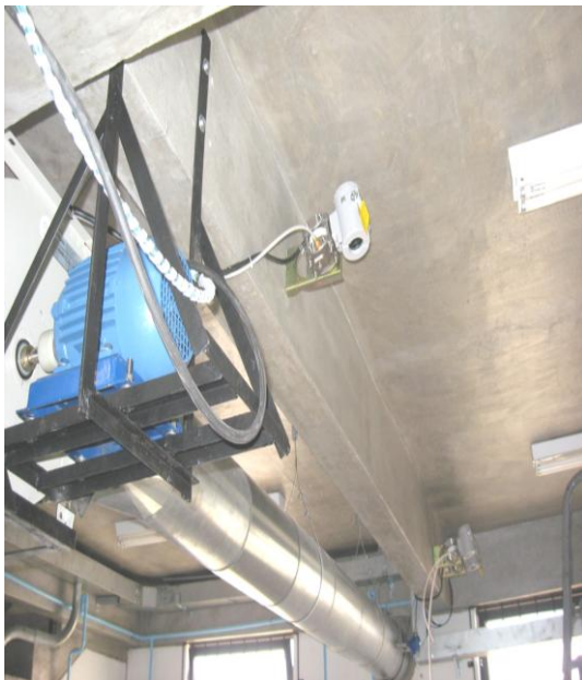
Figura 8. Fotografia da bancada do ventilador com detalhes da tubulação de descarga e motor de acionamento.
